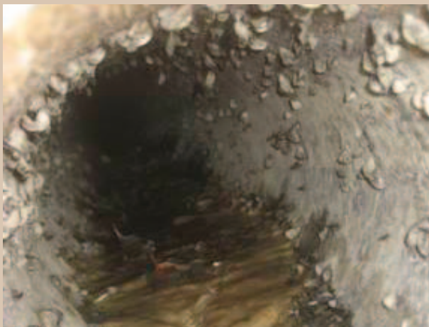
Figura 11. Conducto de captación, afectado por mejillón cebra (Aragón).
