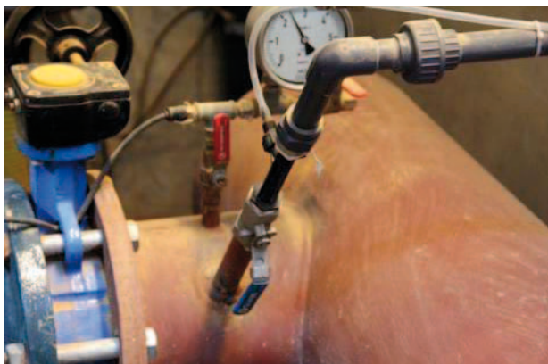
Figura 25. Punto de inyección del ozono a la tubería de captación.
