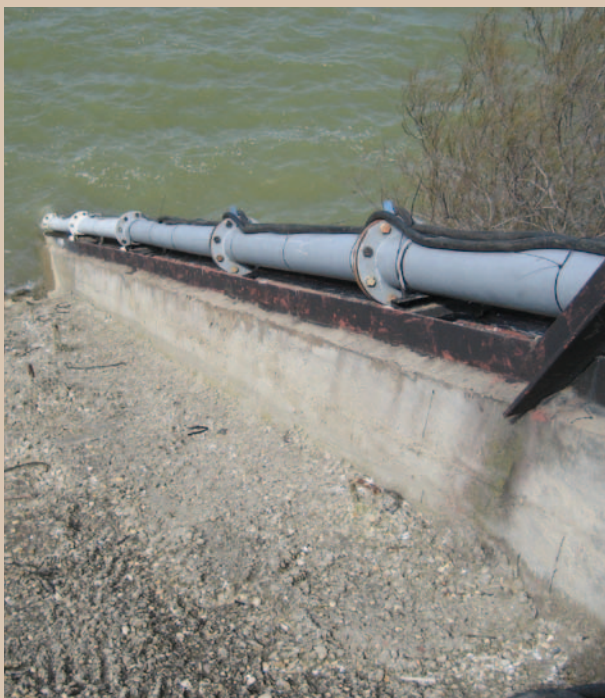
Figura 21. Tubería de captación, con posibilidad de aumentar su profundidad de toma.
