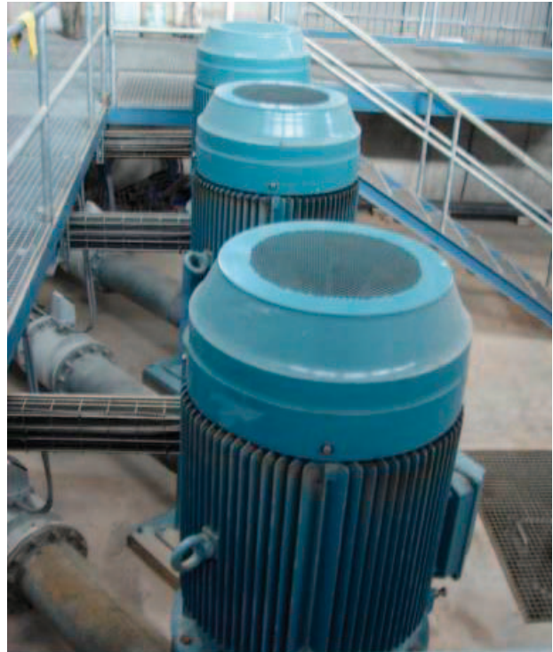
Figura 13. Sistema de bombeo.
