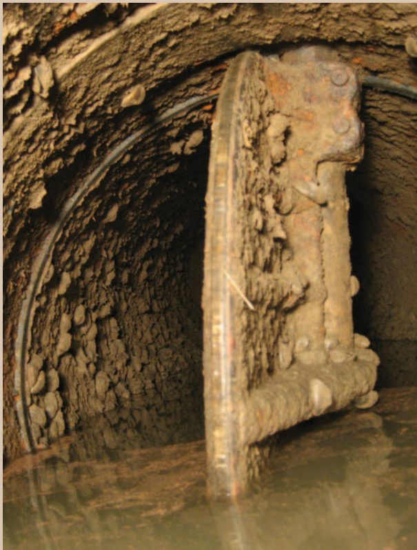
Figura 19. Tubería y válvula de cierre colonizadas por mejillón cebra (Tarragona).
