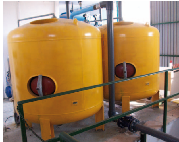
Figura 4. Instalación de filtros de arena (Aragón).
