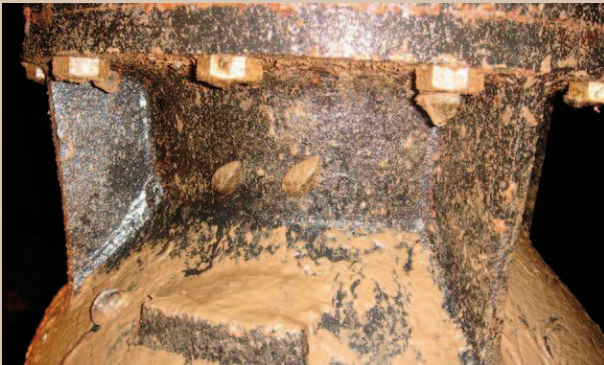
Figura 17. Colonización de mejillón cebra en equipo de bombeo.
