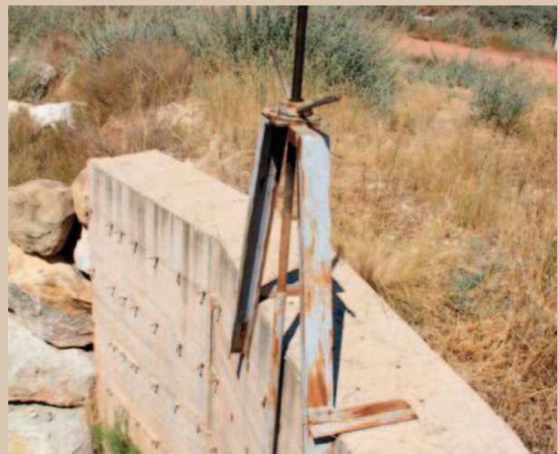
Figura 10. Compuerta de captación.
