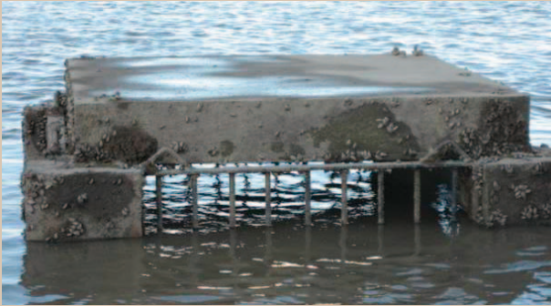
Figura 16. Rejas de protección de la balsa de acumulación colonizada por mejillón cebra (Navarra).
